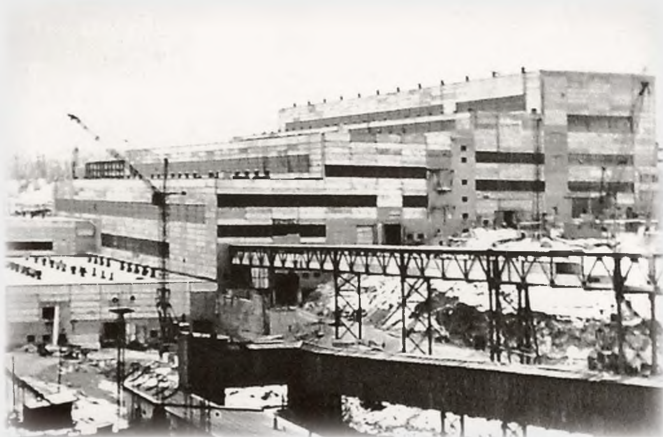
АБОФ перед запуском в эксплуатацию. 1975 г.
