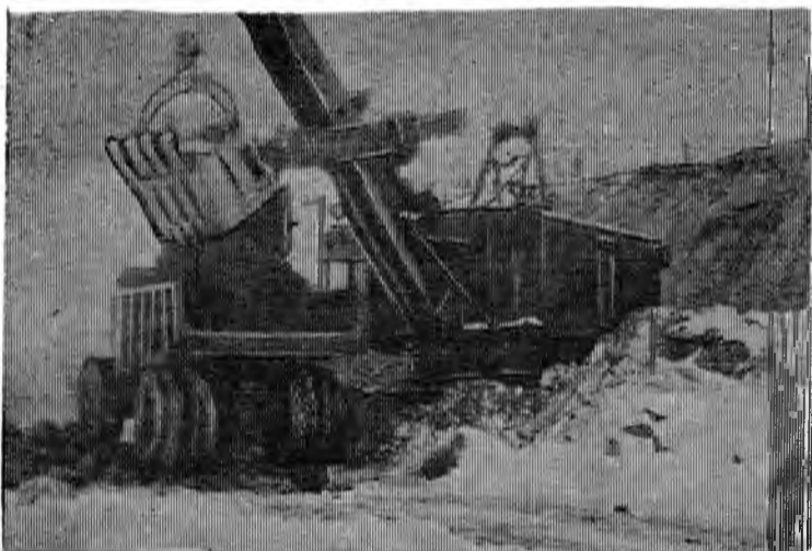
ПОСЕЛОК КОВДОР. Погрузка горной породы на руднике «Железный» экскаватором в автосамосвал. Фото машиниста сушильных барабанов Ж. Терещенко.
