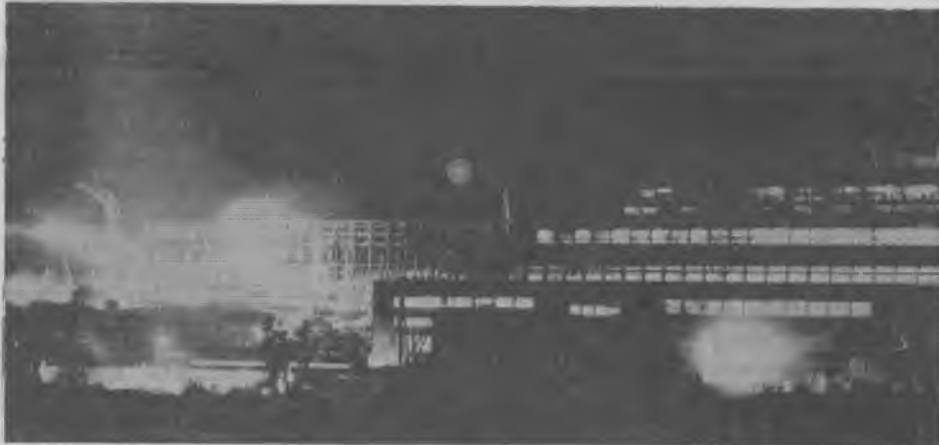
Круглые сутки горят огни в окнах АБОФ. Монтажники работают в первую, во вторую и в третью смены. Фото Ю. Демина.
