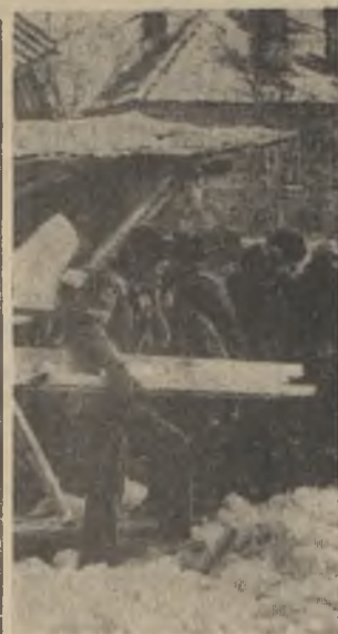
В формированиях жилищно-коммунального управления прошли учения по гражданской обороне. Во время этих учений аварийно-восстановительное звено во главе со звеньевым А. Волковым успешно справились с ликвидацией завала. Фото Н. Ганиевой.
