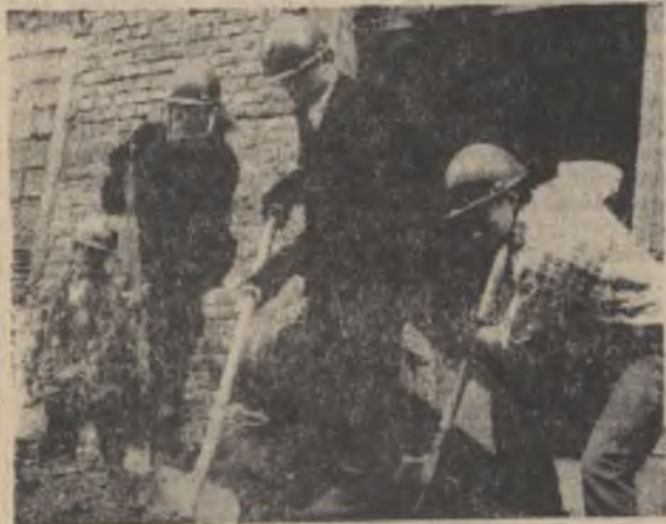
У этих ребят из бригады Владимира Мозгового (отряд «Арктика») объект ответственный — маслоподвал 9-й секции. Бойцы уже освоили 40 тысяч рублей капиталовложений и пока занимают первое место в социалистическом соревновании линейных отрядов РССО «Ковдорский».
