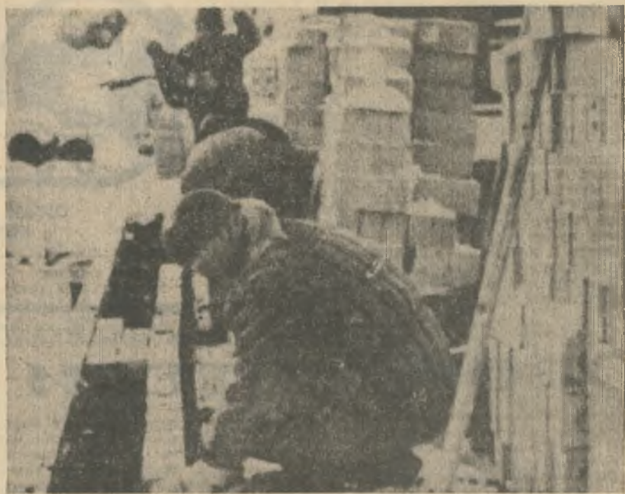
Кирпичную кладку стен ЗРУ главной понизительной подстанции ведет звено Л. Г. Позднякова. Последние кубометры.
